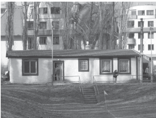
Do šaten u fotbalové hřiště začíná zatékat.
