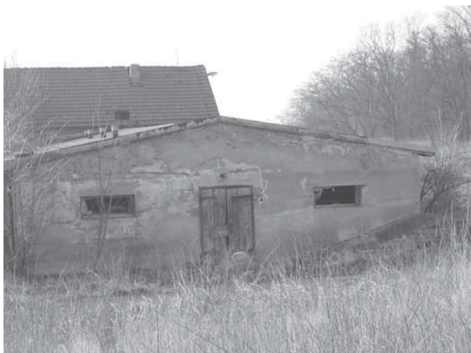
Rozpadající se budova bývalé výkrmny prasat hyzdí obec, navíc není zabezpečena proti vniknutí.
